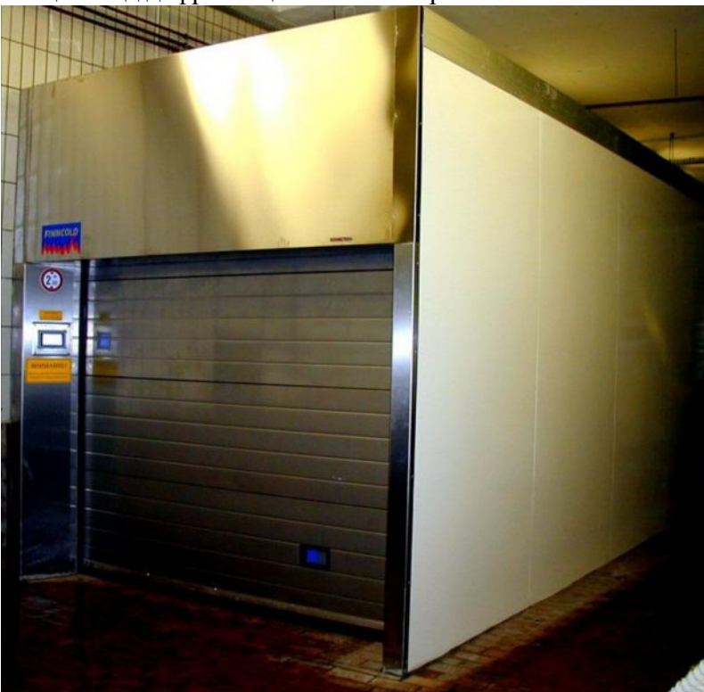
Общий вид дефростационной камеры
